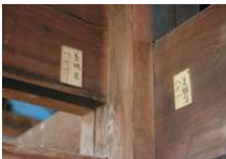
武部建設の敷地内に仮組みされ、新しい家主を待つばかりの古民家。長沼に明治43年に建てられた福井県出身の開拓農民の民家です。構造材は解体する際に全て大工によって番付されます(写真下)。
